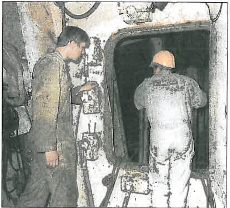
Schicht-Ingenieur Dieter Neumann (links) im Überdruckbereich von Trude. Kurz nach Aufnahme des Fotos stürzten Teile der Tunnelwand ein.
