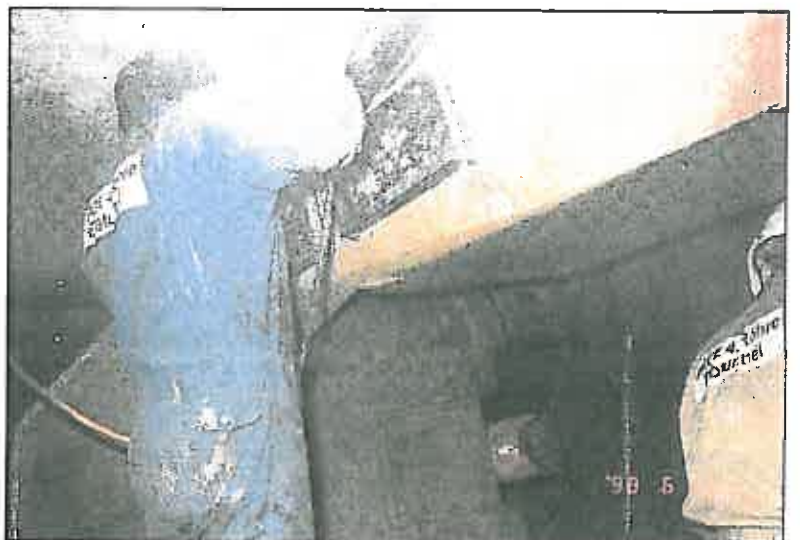
Unter Überdruck schweißt ein ARGE-Mitarbeiter Verschleißschutzplatten. Minuten später bricht die Wand ein. Vier Arbeiter drohen zu ertrinken.
